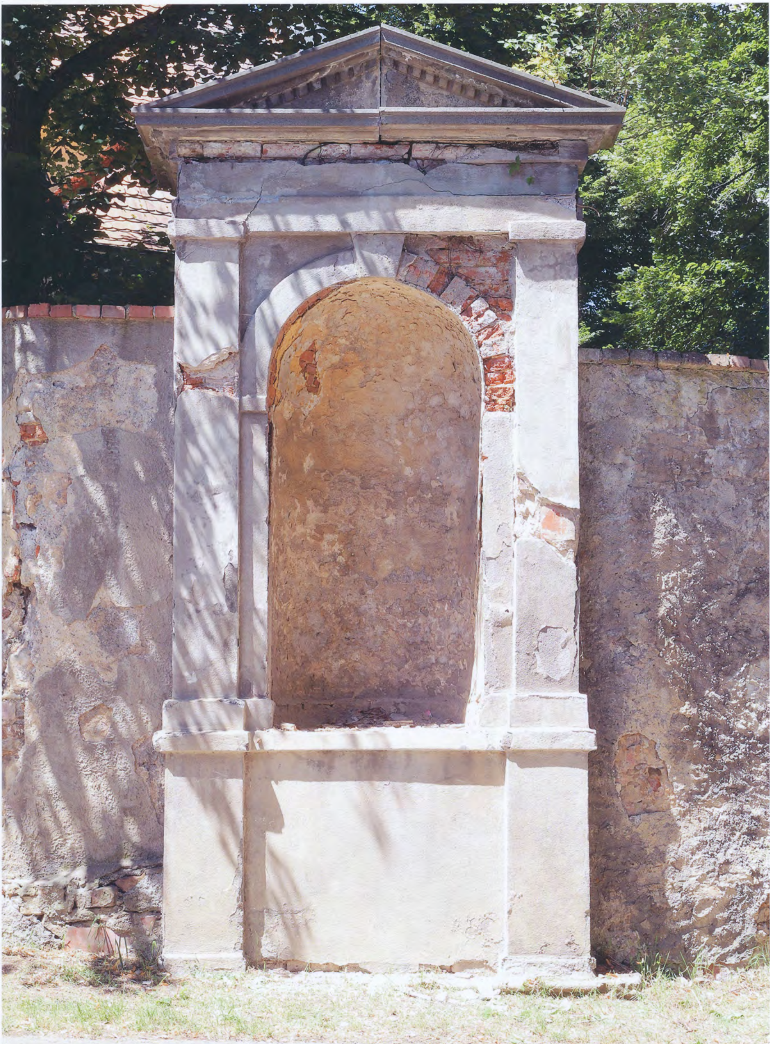
2. Liteň – Výklenková kaple se sochou v ohradní zdi kostela sv. Petra a Pavla – stav před restaurováním po demontáži sochy
